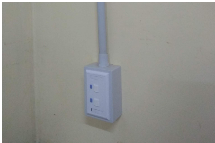
Bocas de red en aulas
