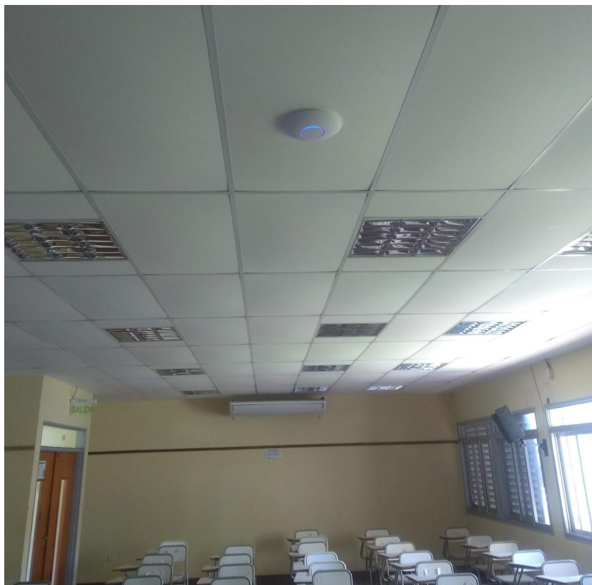
Punto de acceso en aula
